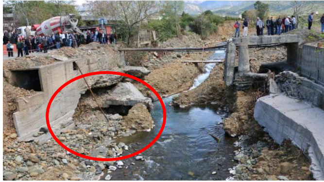
Resim 8. Arsuz ilçesi Höyük Köprüsü Taşkın sonrası yıkılmış görüntüsü
